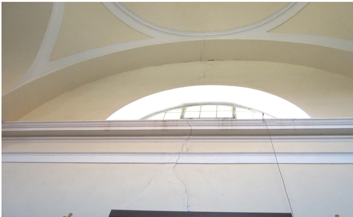
Kostel sv. Václava v Troskotovicích – svislé trhliny na obvodové zdi
