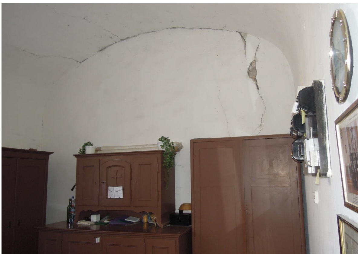
Kostel sv. Václava v Troskotovicích – trhliny uvnitř sakristie
