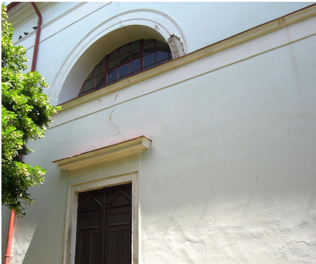
Kostel sv. Václava v Troskotovicích – trhliny nad bočními dveřmi a oknem
