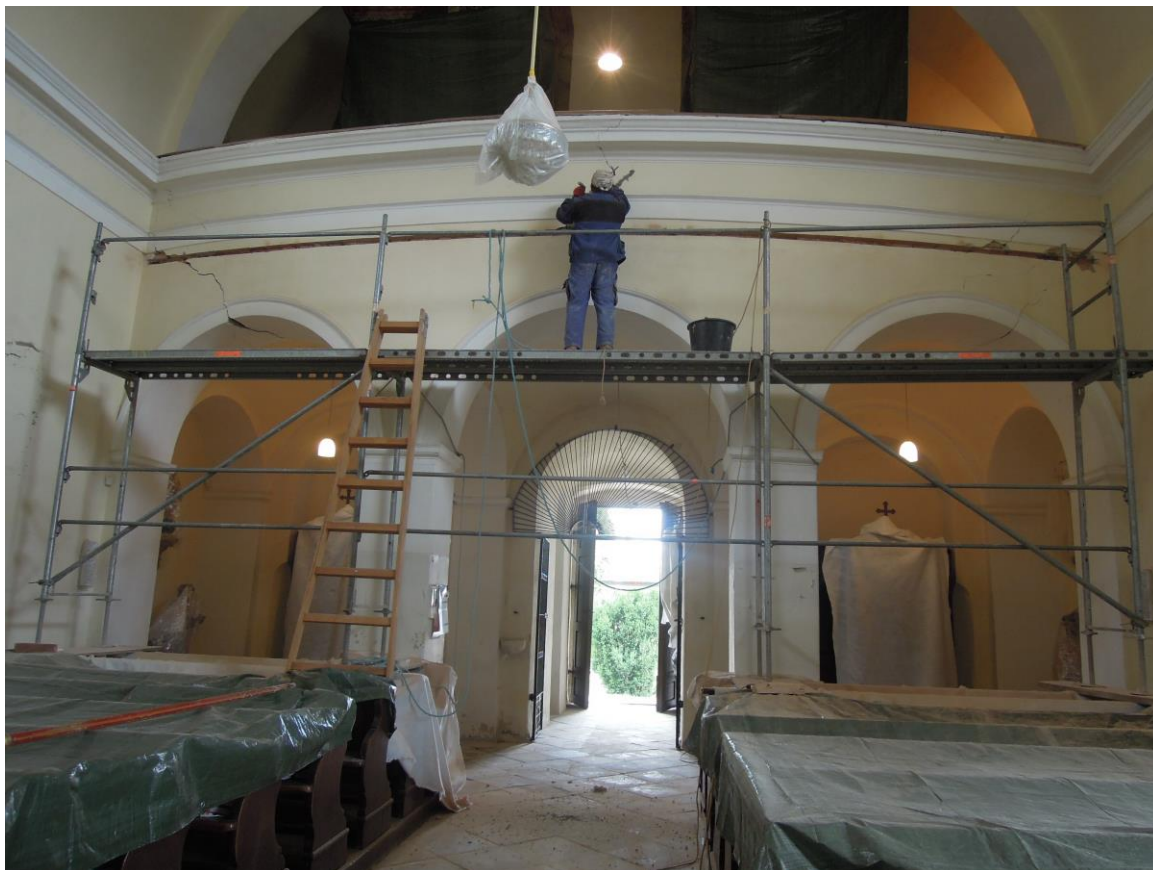
Kostel sv. Václava v Troskotovicích – statické zajištění
