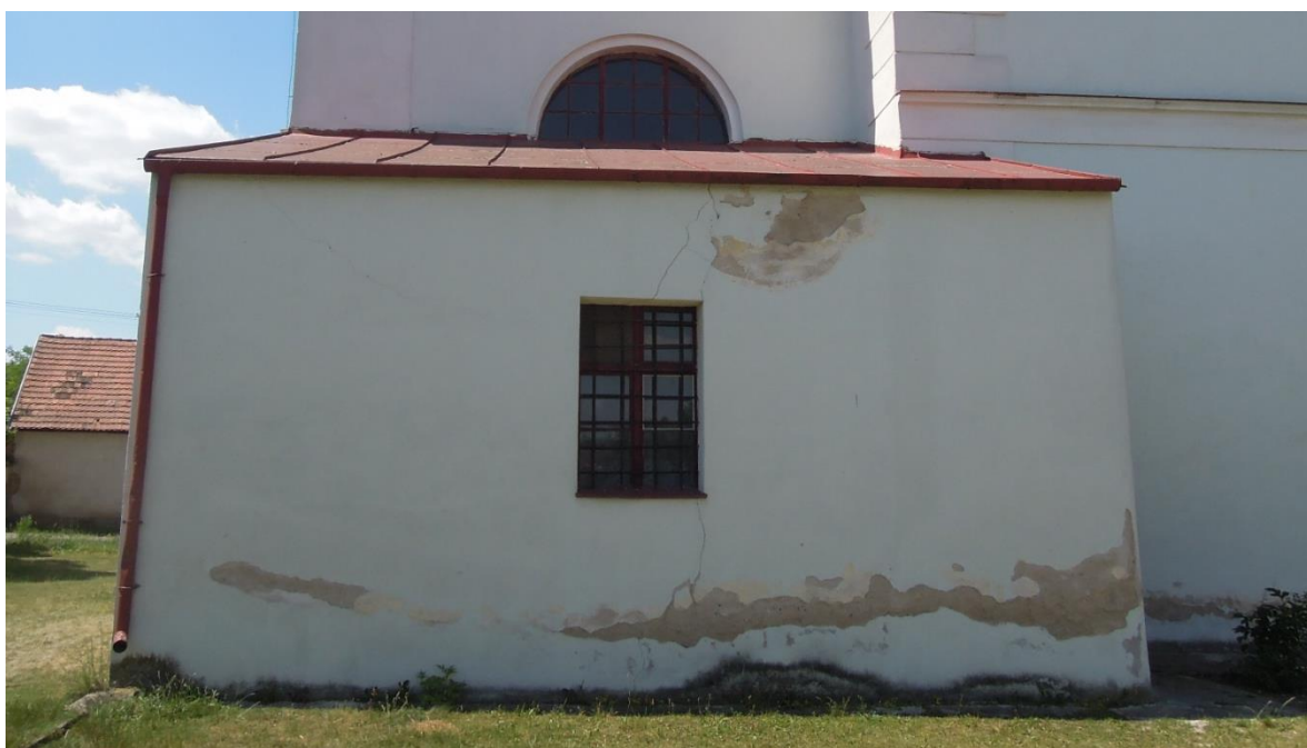
Kostel sv. Václava v Troskotovicích – trhliny nad a pod oknem sakristie
