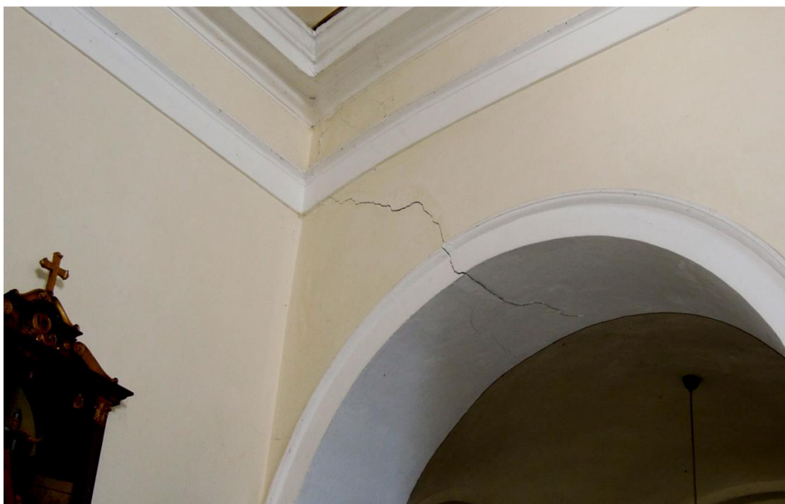
Kostel sv. Václava v Troskotovicích – trhliny v oblouku pod kůrem
