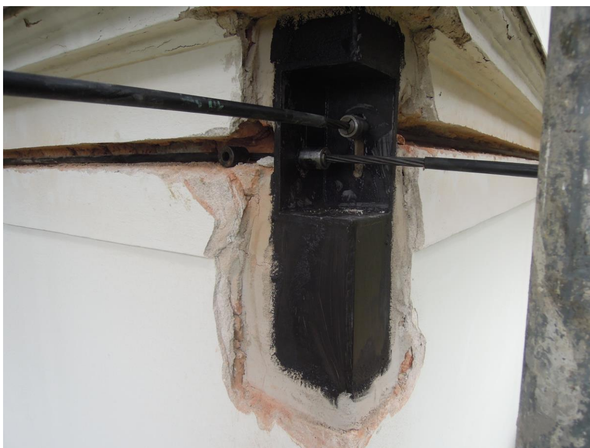
Kostel sv. Václava v Troskotovicích – statické zajištění
