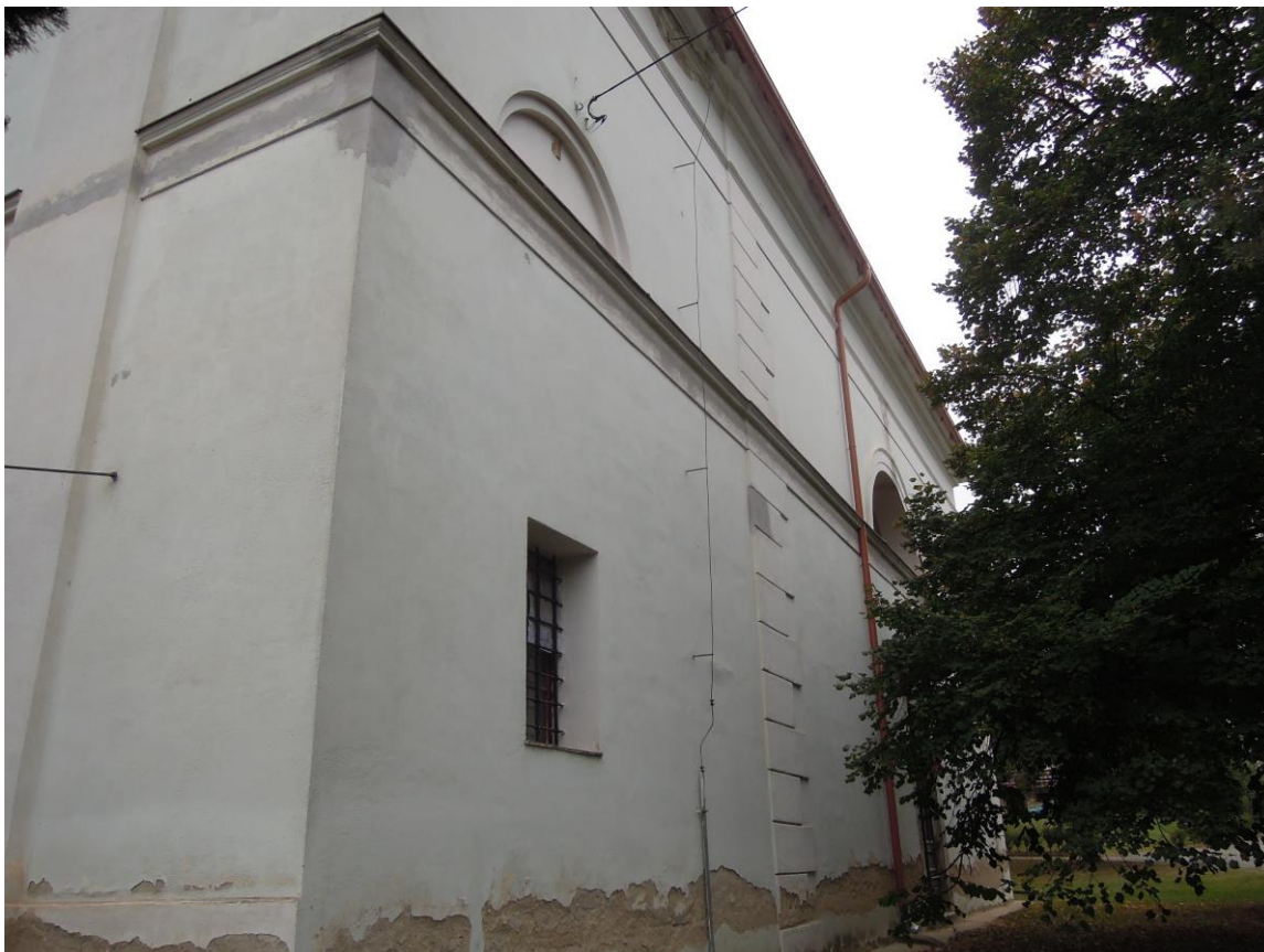
Kostel sv. Václava v Troskotovicích – statické zajištění
